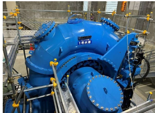
発電機（横軸フランシス水車）
