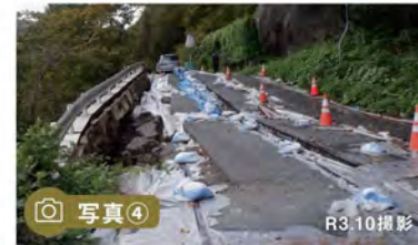
道路の沈下と擁壁の変状が発生
