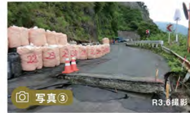
道路では約30cmの段差が発生
