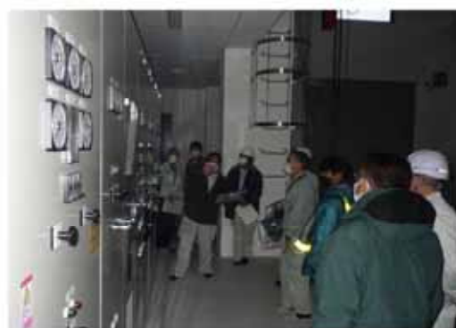
屋内の制御盤前、通電期間外なので夕方は薄暗い（懐中電灯があれば問題ない、盤内には市販の乾燥材）
