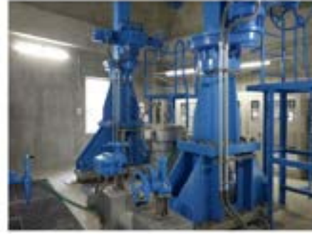
放流施設内の放水ゲート
